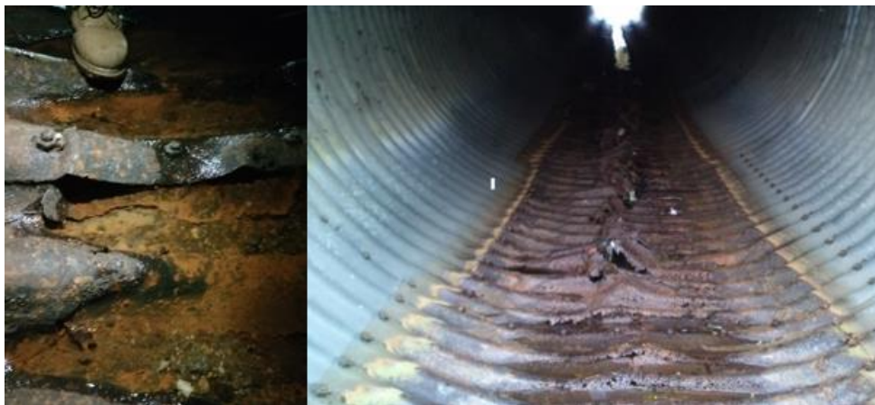
Figura 2.2 – Pormenor da corrosão ao nível de soleira identificado numa inspecção a uma PH.
