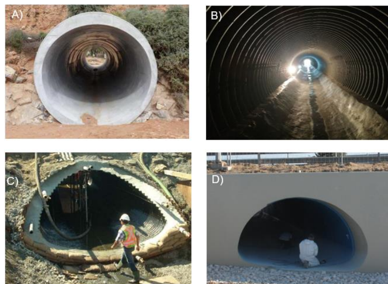
Figura 2.3 – Diferentes soluções de reabilitação de passagens ARMCO: A) aplicação de betão em toda a secção [9]; B) aplicação de betão ao nível de soleira; C) reforço com nova tubagem de aço [9]; D) solução em GFRP.
