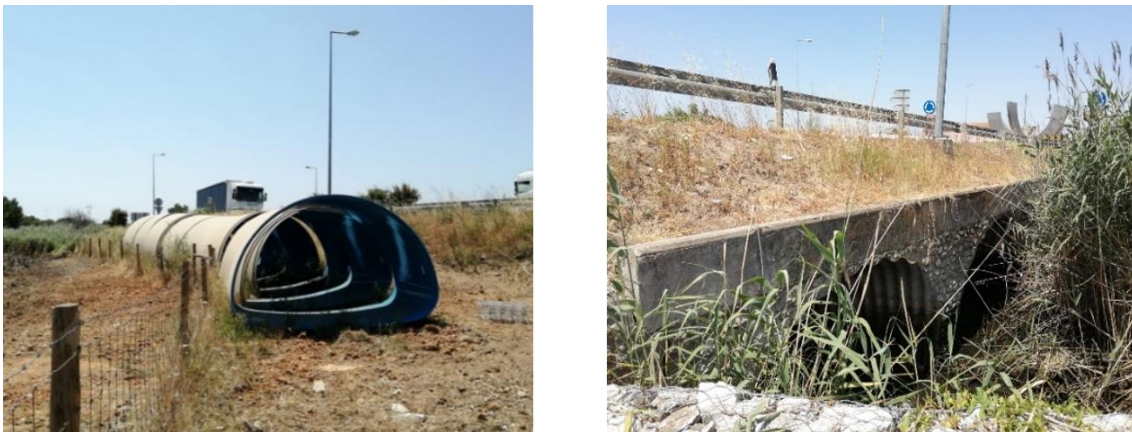
Figura 5.2 – Passagem hidráulica em estudo antes do início da reabilitação (esquerda) e tubos usados na reabilitação (direita).
