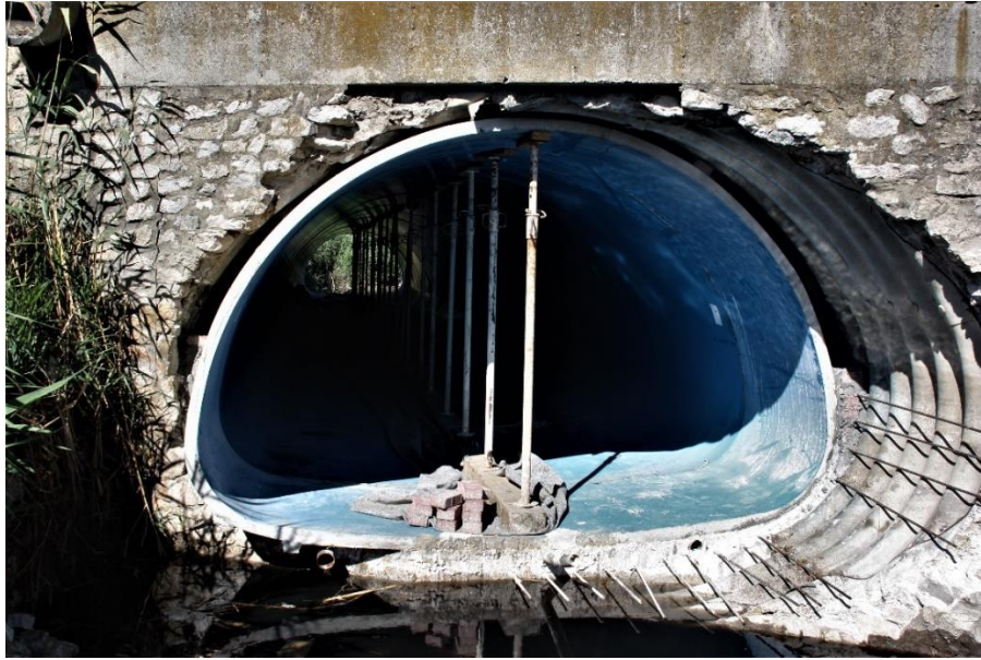
Figura 5.9 – Pormenor que mostra as fases um e dois de injeção do grout.
