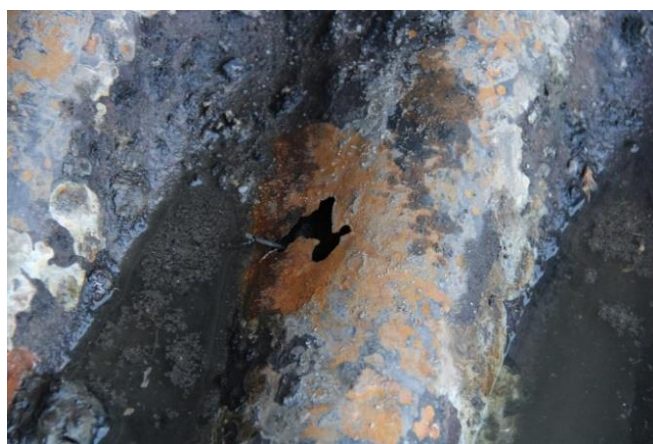
Figura 5.5 – Pormenor de corrosão de picada encontrado na PH.
